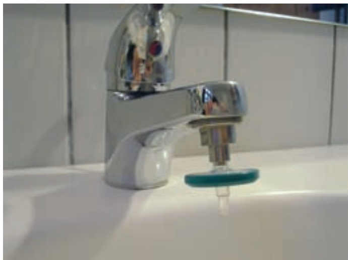
Haneadapter med filter monteret på vandarmatur.
