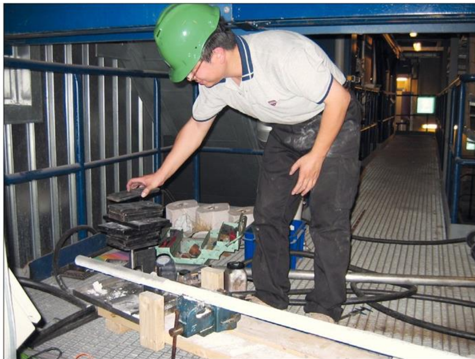
Figur 3. En belægningssonde efter eksponering, Avedøreværket, blok 2, november 2005.
