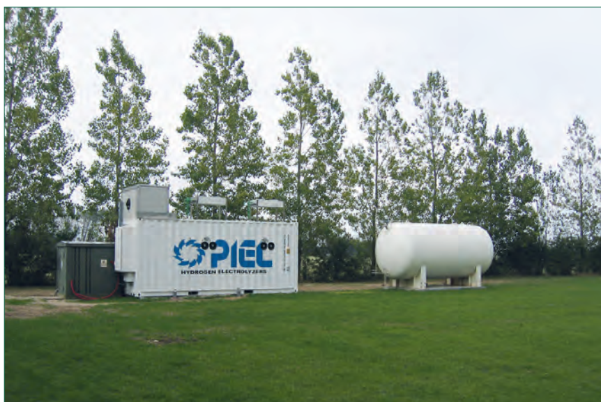
Figur 1. Elektrolysør og lagertank.
