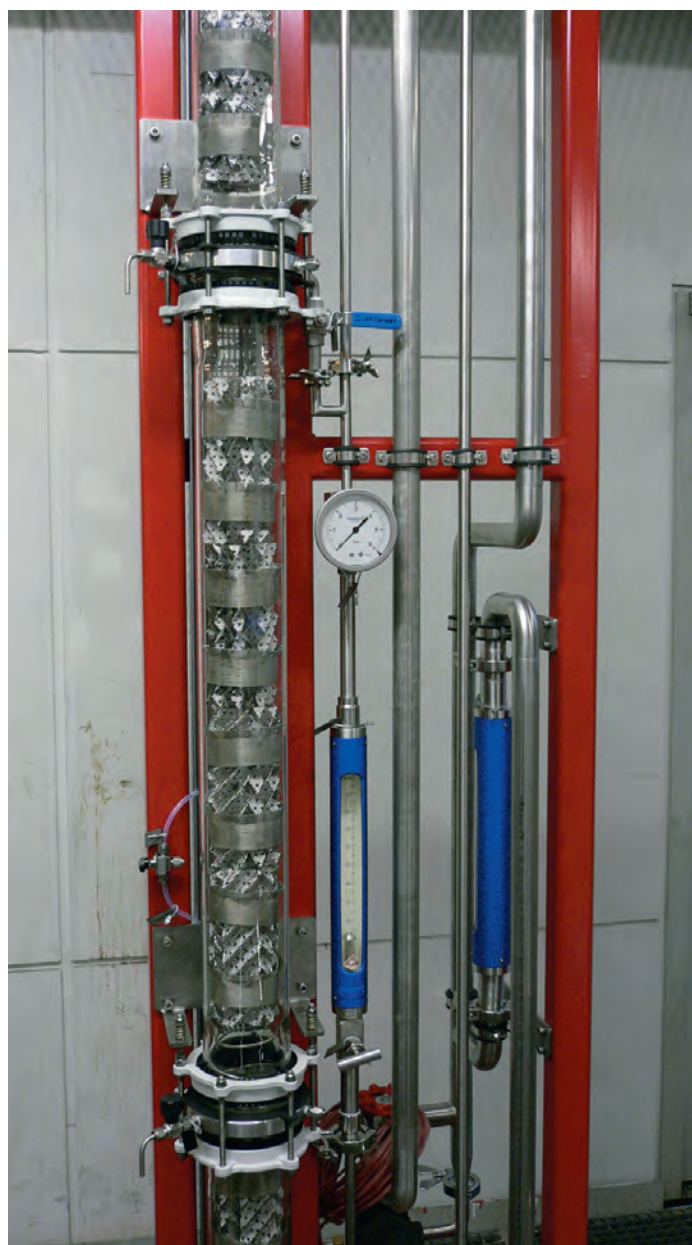
Udsnit af absorberanlæg. Selve kolonnen ses til venstre på billedet.
