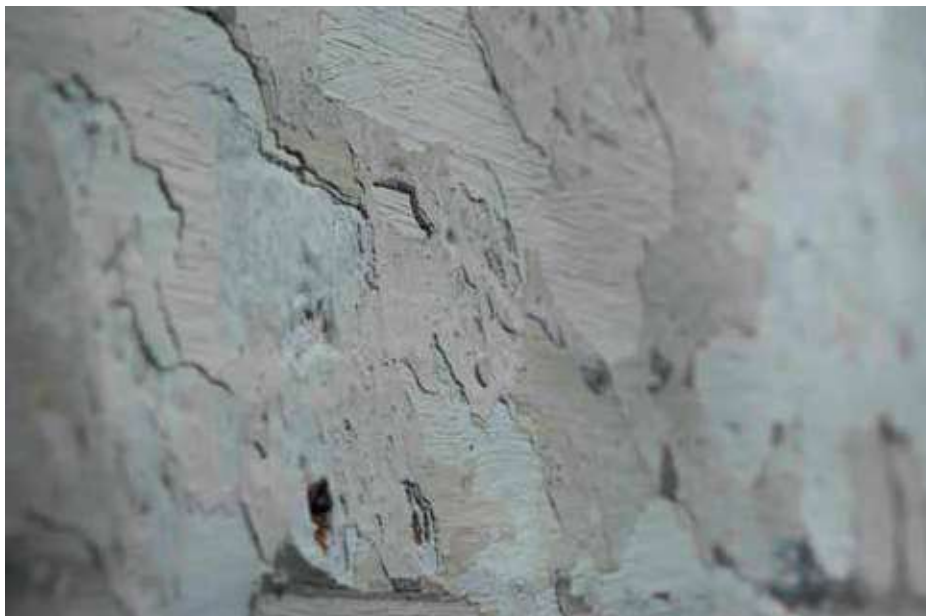
Figur 4. Kalklag i Aarhus Domkirke. Det ses, hvordan lag af hvidtekalk og puds ligger oven på hinanden, og hvor det øverste lag er skallet af, træder de ældre lag frem.
