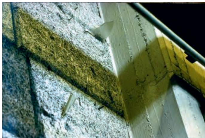
Figur 2. Glassplinter fra ødelagt vindue borede sig ind i en væg af letbeton (Kilde: Bjerketvedt and Mjaavatten, 2005).
