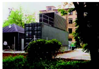
Figur 2. Actiflo-anlægget ved Emdrup Sø er indbygget i en container, så det kan flyttes, når vandkvaliteten i vandsystemet er tilfredsstillende. Anlægget har en kapacitet på 375 m 3 /h.
