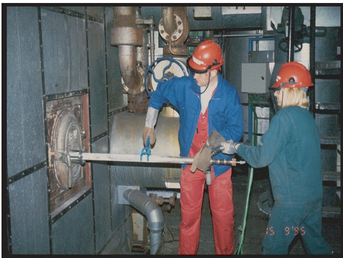
Figur 1. Medarbejdere fra CHEC (Combustion and Harmful Emission Control)-forskningscentret på Institut for Kemiteknik, DTU, ses i færd med at tage en kølet rørsonde ud af en kedel på Kyndbyværket.
