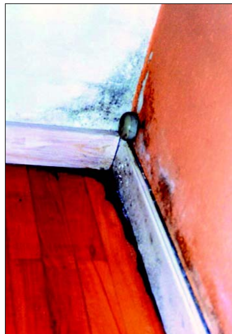
Figur 1. Dårligt isoleret væg kombineret med meget fugtigt indeklima medfører vækst af skimmelsvampe.
